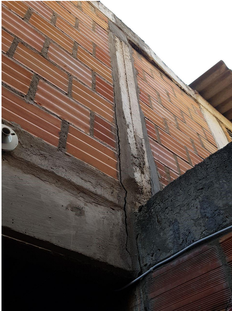
Foto 2. Mala calidad de las viviendas en la Comunidad del Barrio Buena Vista II
